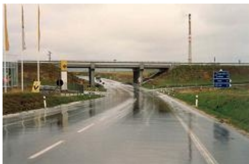
Obr. 1: Dřívě nehodová zatáčka na okraji Písku (den)
