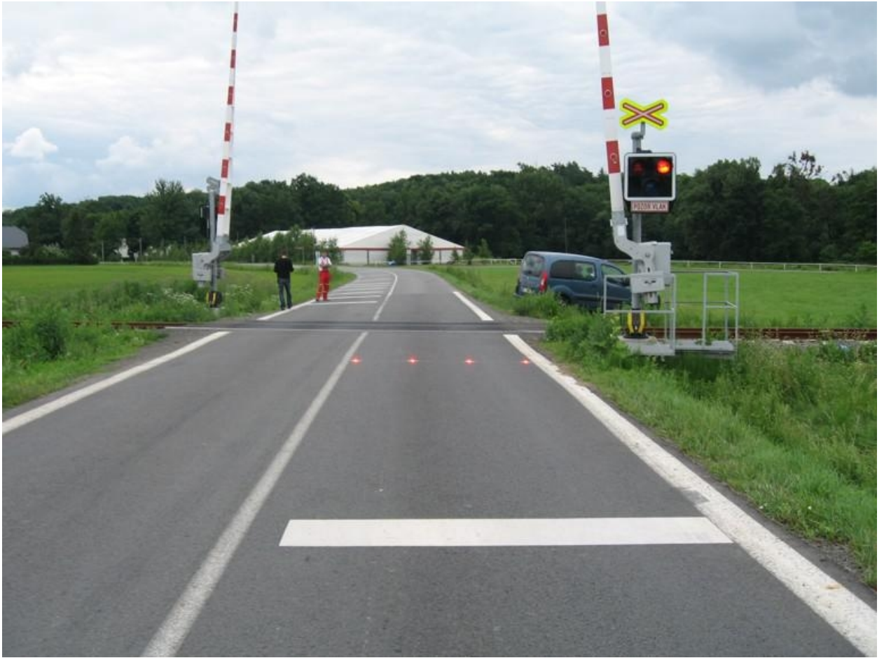
Obr. 4 - Světelná závora v Oticích
