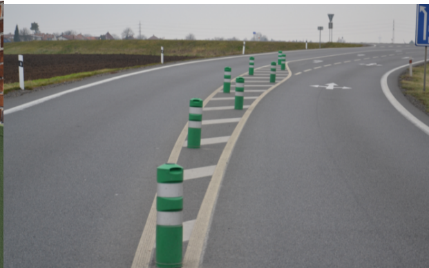
Obrázek 09. Směrové sloupky zelené kulaté - baliseta
